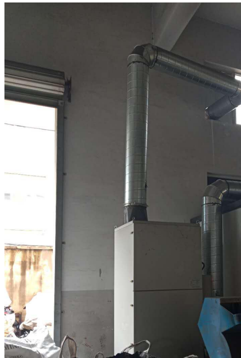
粉尘处理设施
