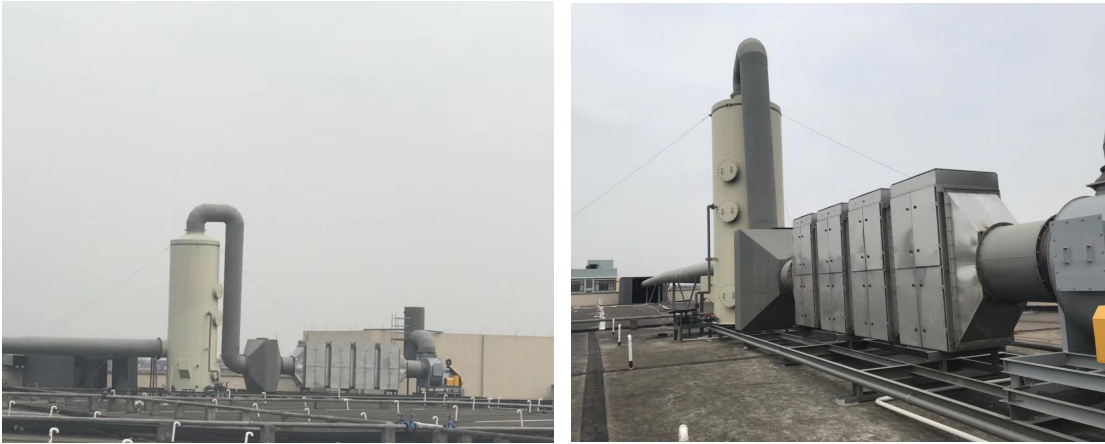
油漆废气处理设施
