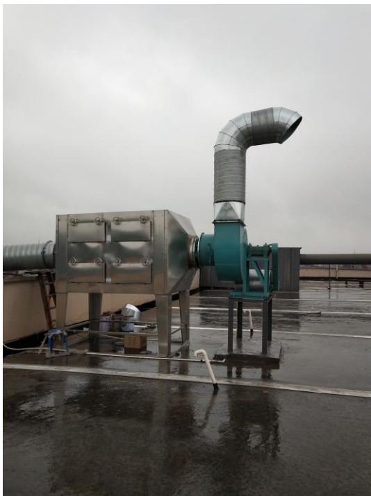
注塑废气处理设施
