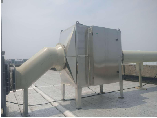
废气处理设施
