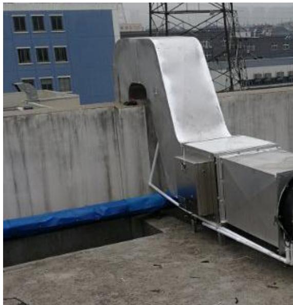
油烟废气处理设施
