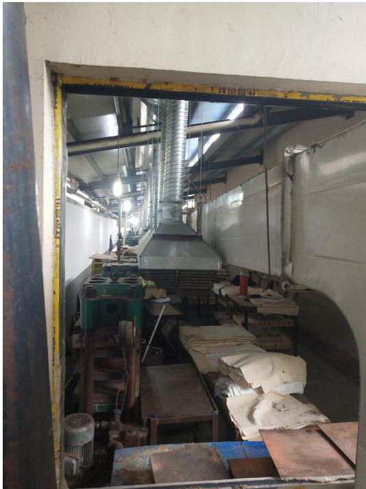
平板硫化废气收集装置
