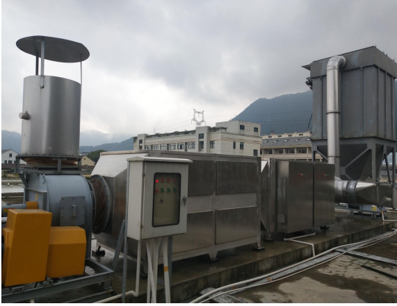
布袋除尘+光氧催化+活性炭 (炼胶废气处理设施)
