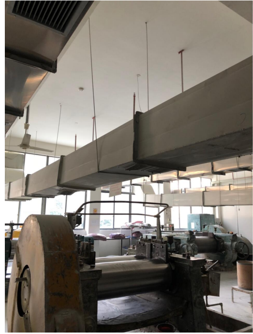
开炼废气收集装置
