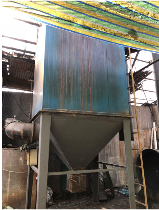
锅炉布袋除尘设施
