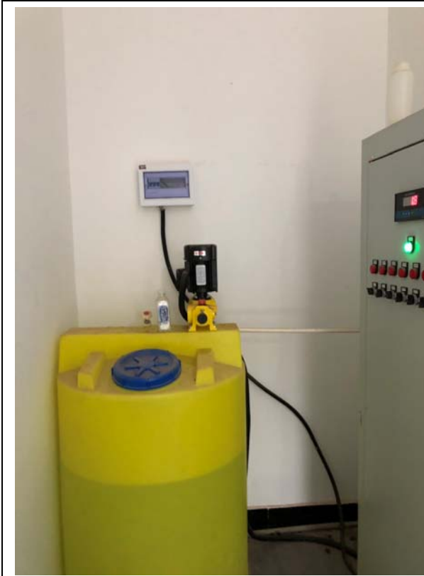
医疗废水处理系统
