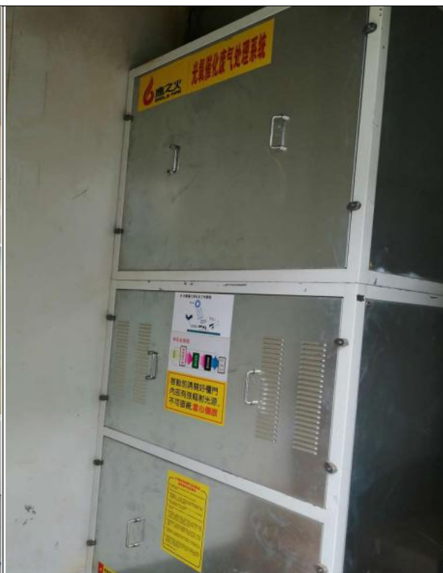
一体式废气处理设施
