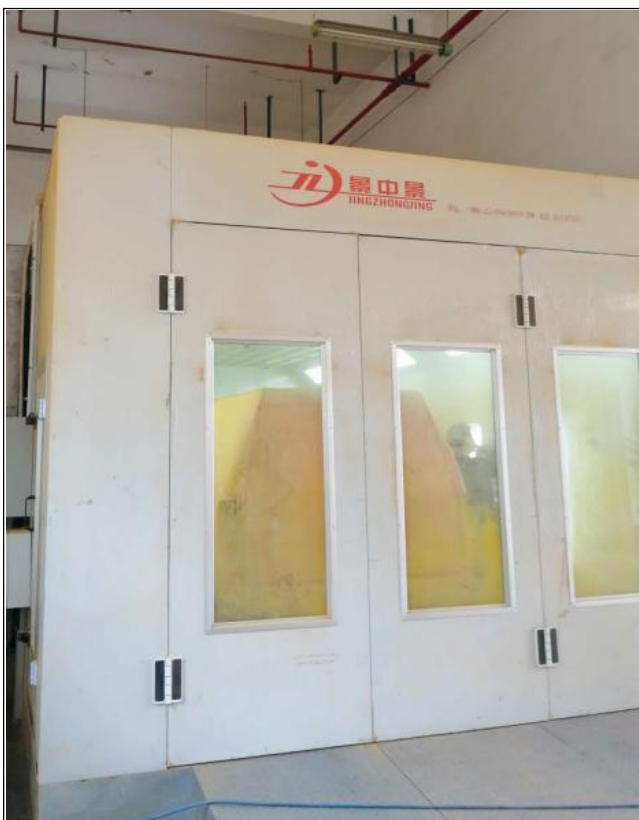
封闭式喷漆房
