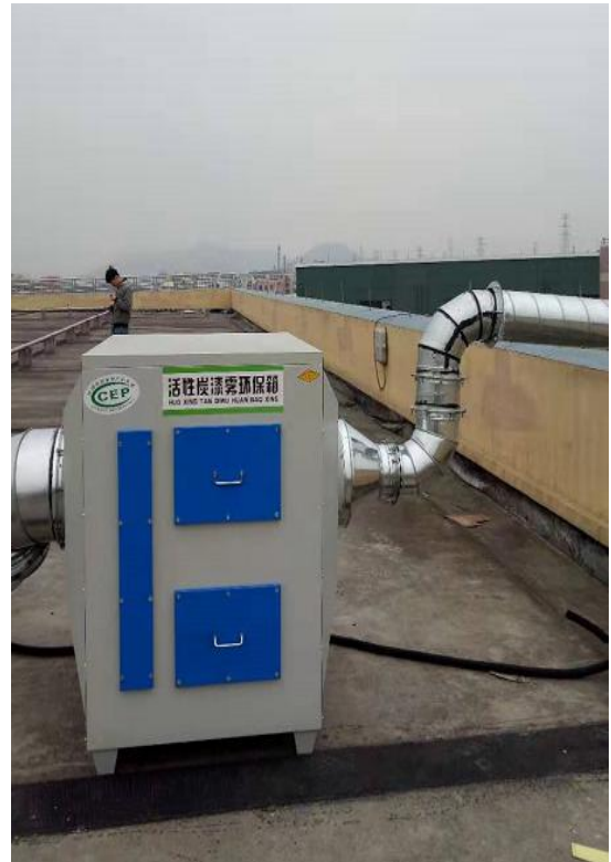
废气处理设施
