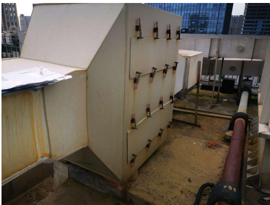
3号楼有机废气处理设施（二）
