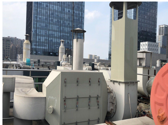
4号楼有机废气处理设施
