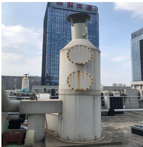
4号楼无机废气处理设施
