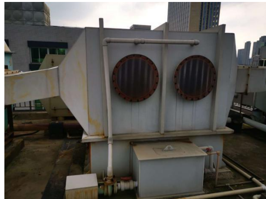
3号楼无机废气处理设施
