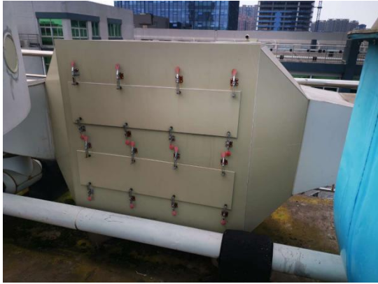
3号楼有机废气处理设施（一）
