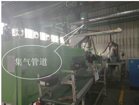
注塑区集气管路
