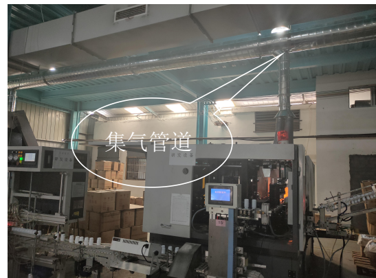
吹瓶区集气管路
