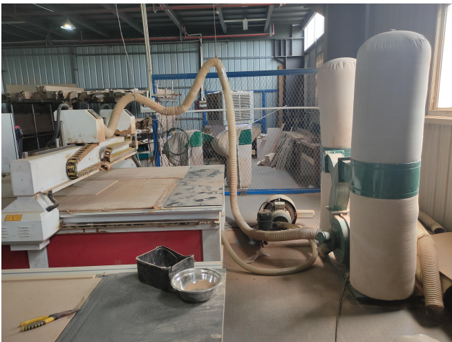
木材加工（除尘设施）
