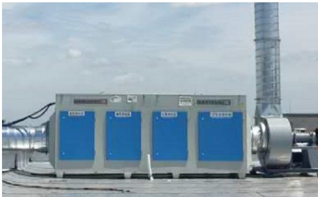
废气处理设施
