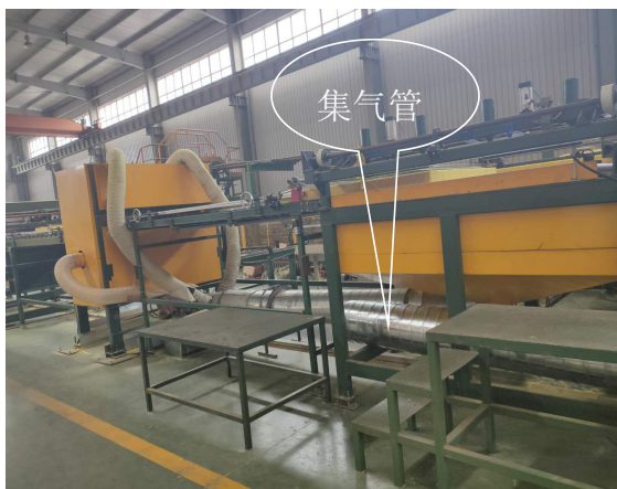
发泡废气收集管路
