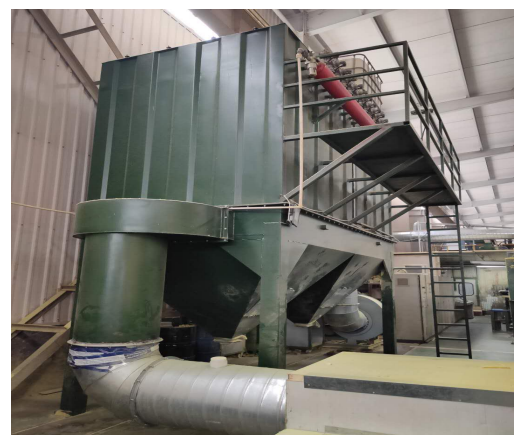
发泡废气处理设施（布袋除尘）
