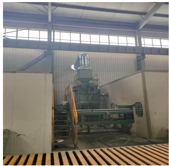
定长切割废气处理设施（布袋除尘）
