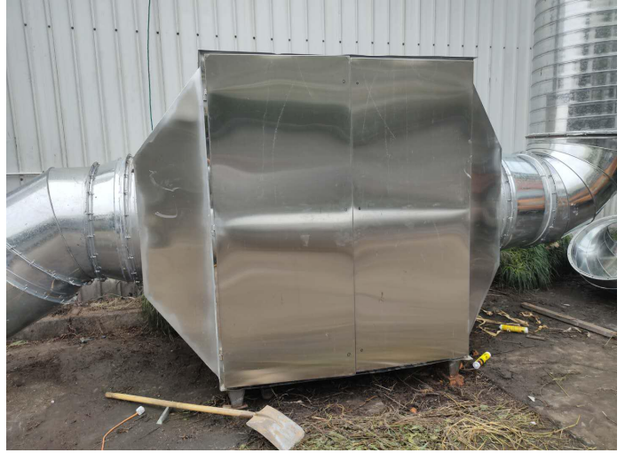
发泡废气处理设施（活性炭）
