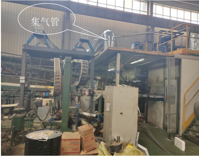
发泡废气集气管路
