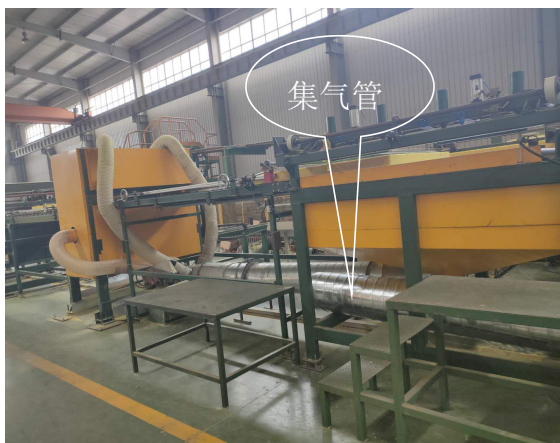
发泡废气收集管路
