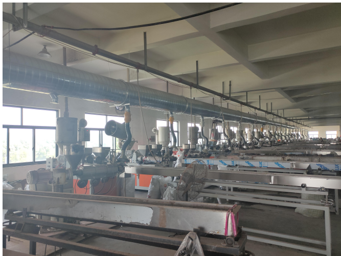
挤出废气收集管路
