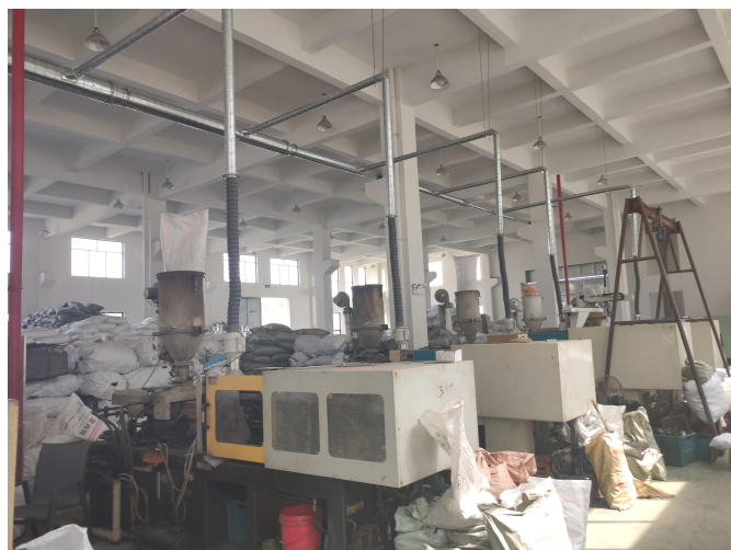
注塑废气收集管路
