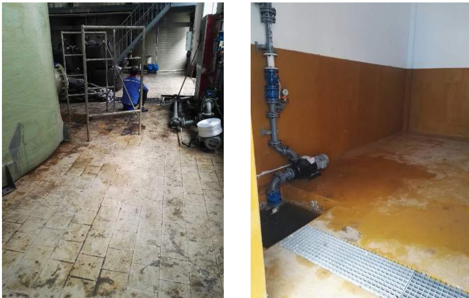
图 4-5 湿法车间耐酸砖及企业危废暂存库防腐防渗地面照片
