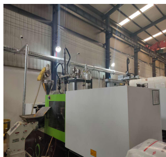
废气收集管路
