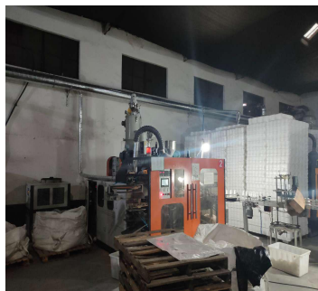
废气收集管路
