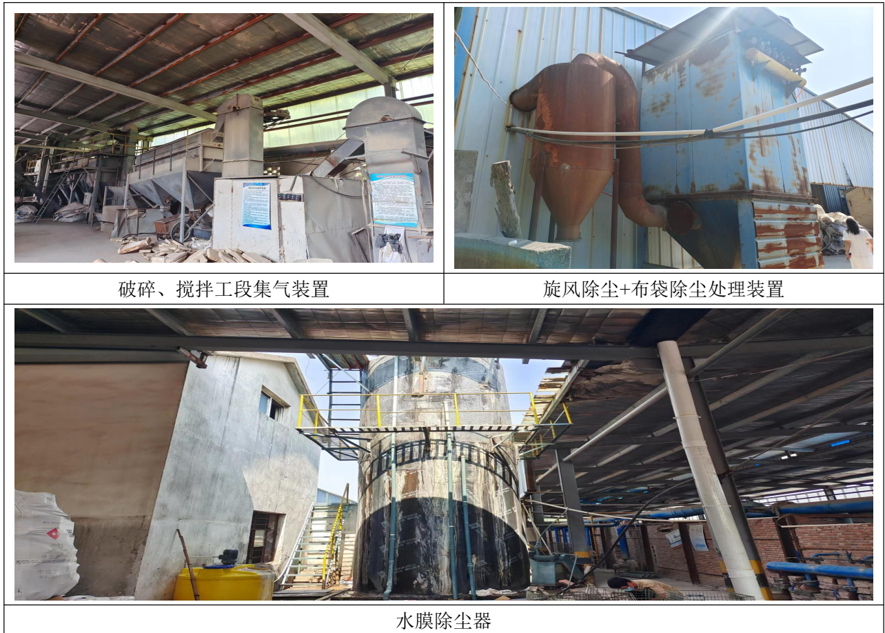
图 4-2 项目部分环保设施照片
