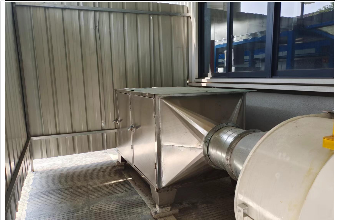
干式过滤+活性炭吸附设施
