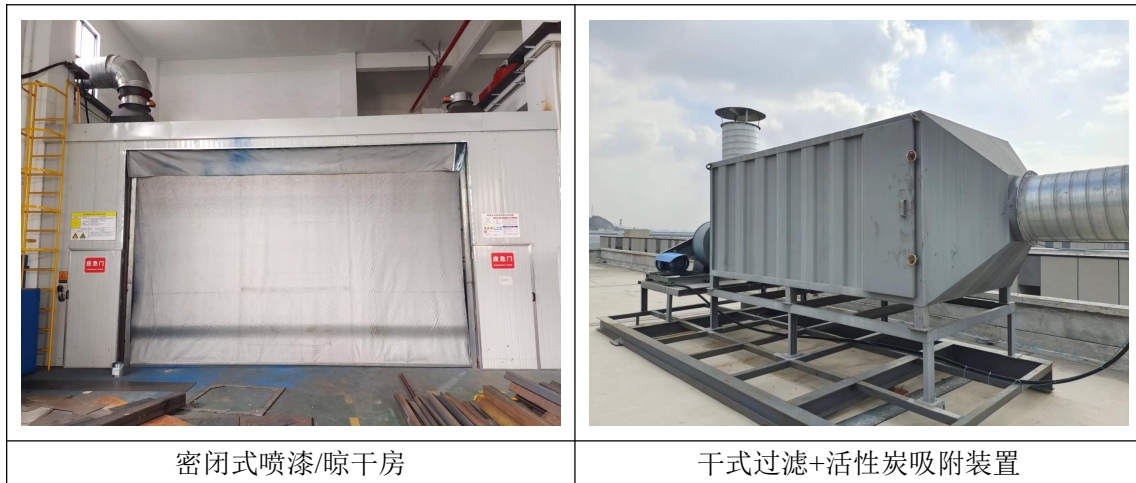
图 4-3 项目废气收集及处理设施图片
