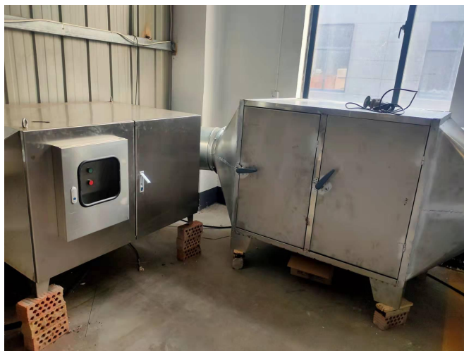
废气处理设施
