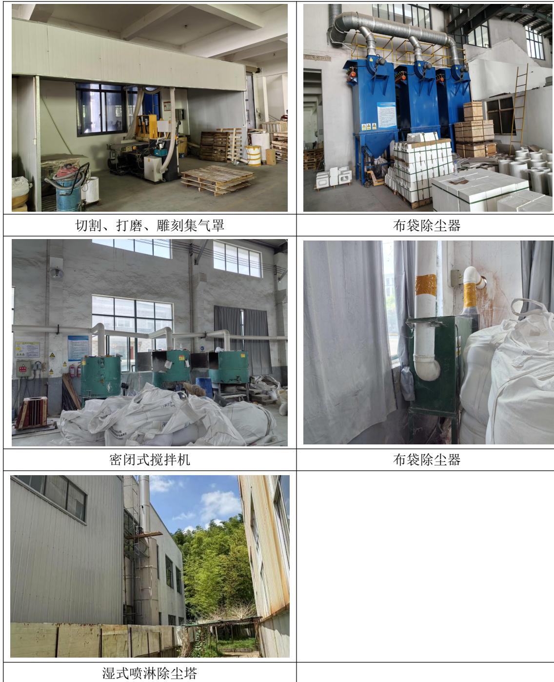
图 4-3 本项目废气处理设施照片
