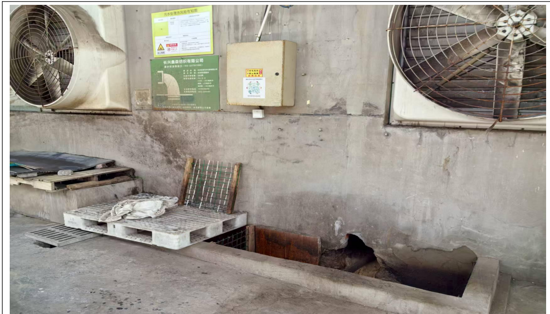
生产废水排放口
