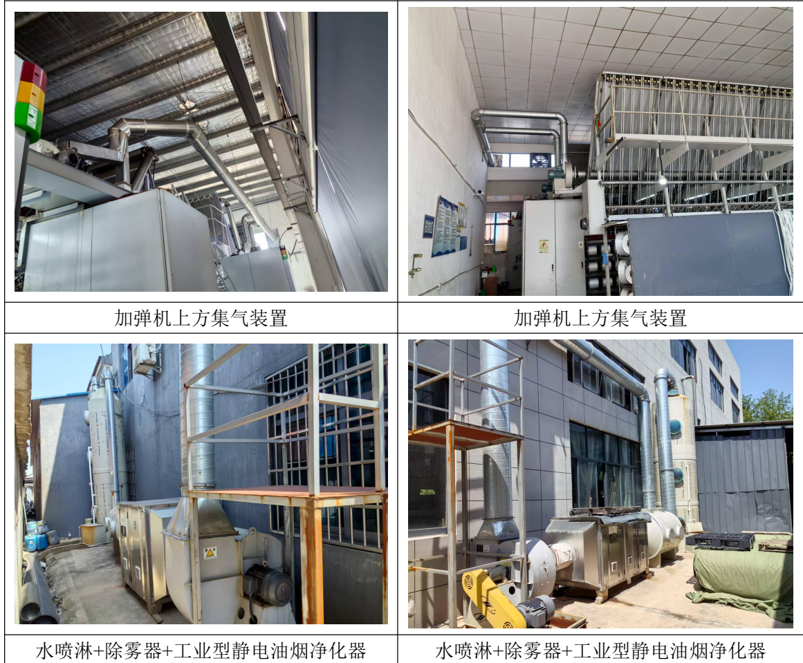
图 4-3 本项目废气处理设施照片
