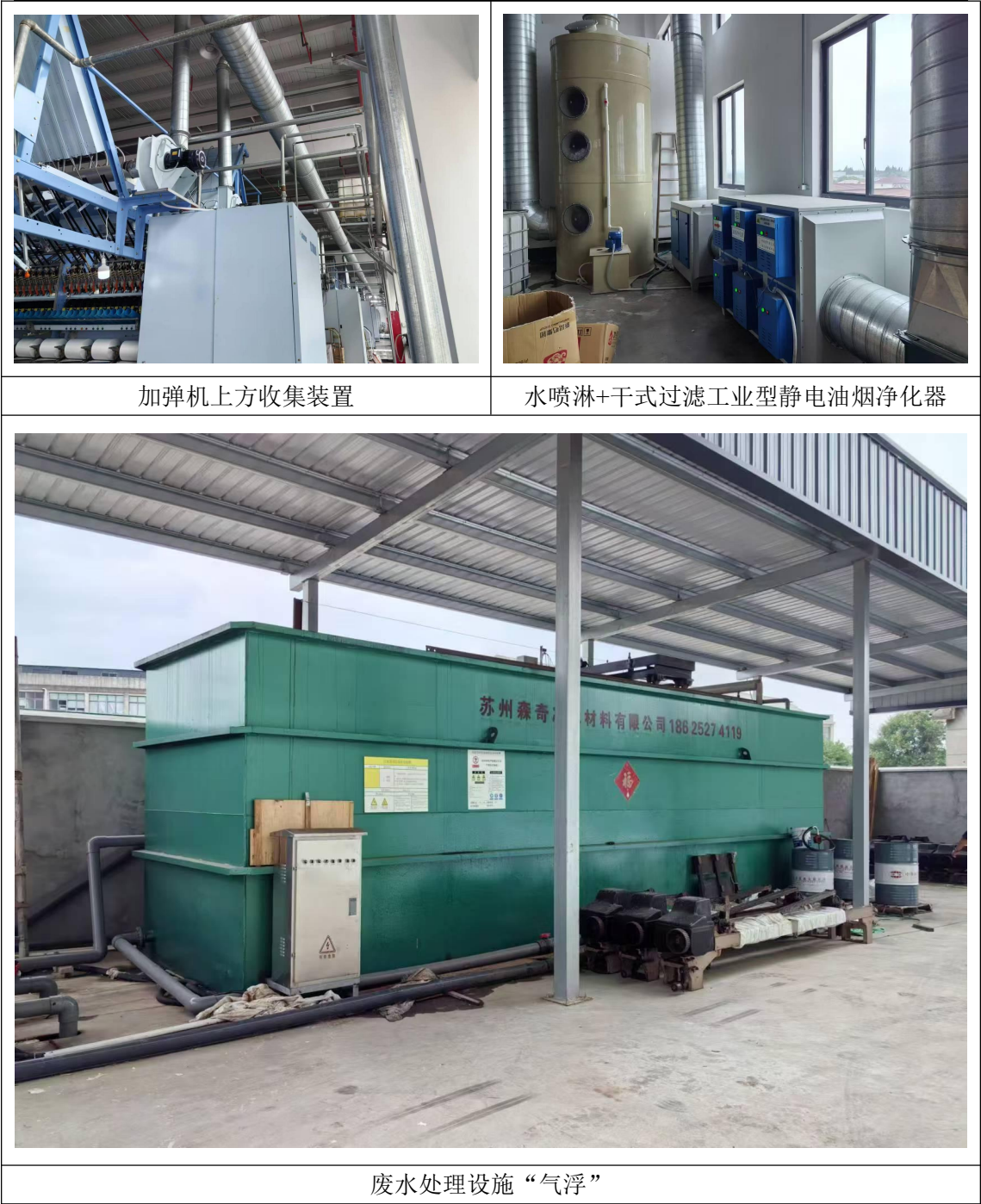
图 4-3 本项目废气、废水处理设施照片
