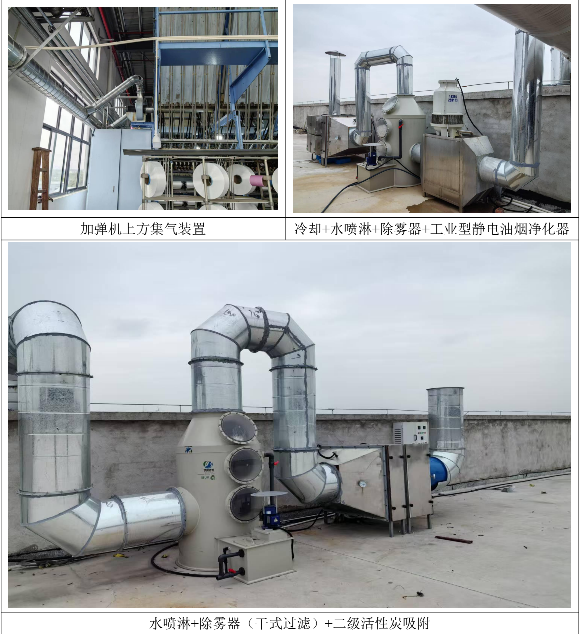
图 4-3 本项目废气处理设施照片
