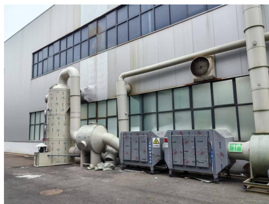
水喷淋+除雾器+二级活性炭吸附
