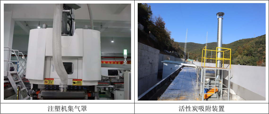
图 4-3 本项目废气处理设施照片
