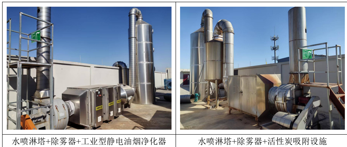
图 4-3 本项目废气、废水处理设施照片
