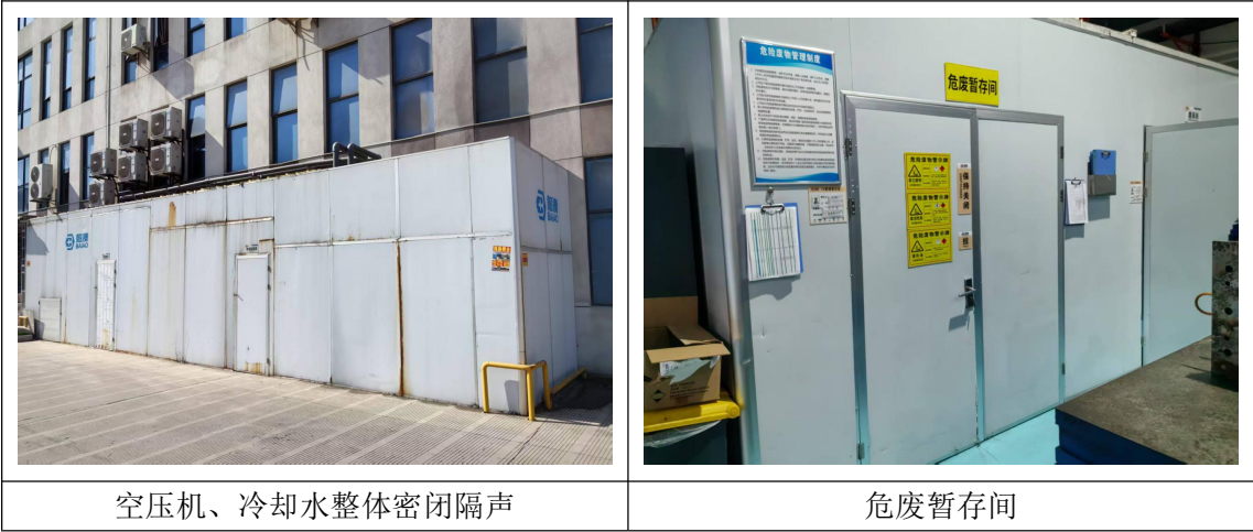
图 4-4 本项目噪声防治措施及危废暂存库照片
