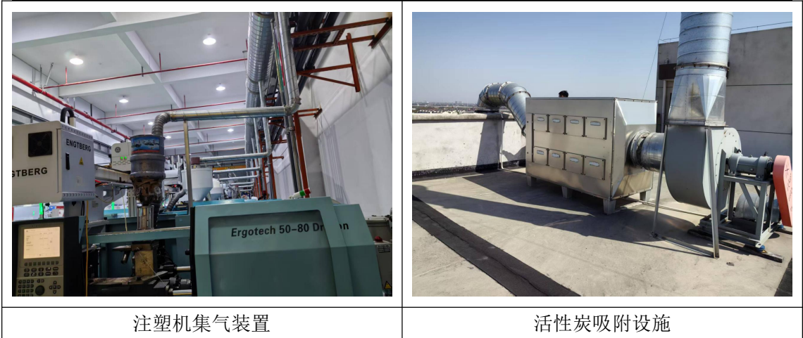
图 4-3 本项目废气处理设施照片
