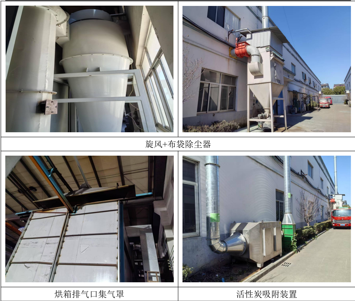
图 4-3 本项目废气处理设施照片
