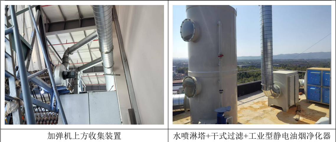
图 4-3 本项目废气、废水处理设施照片
