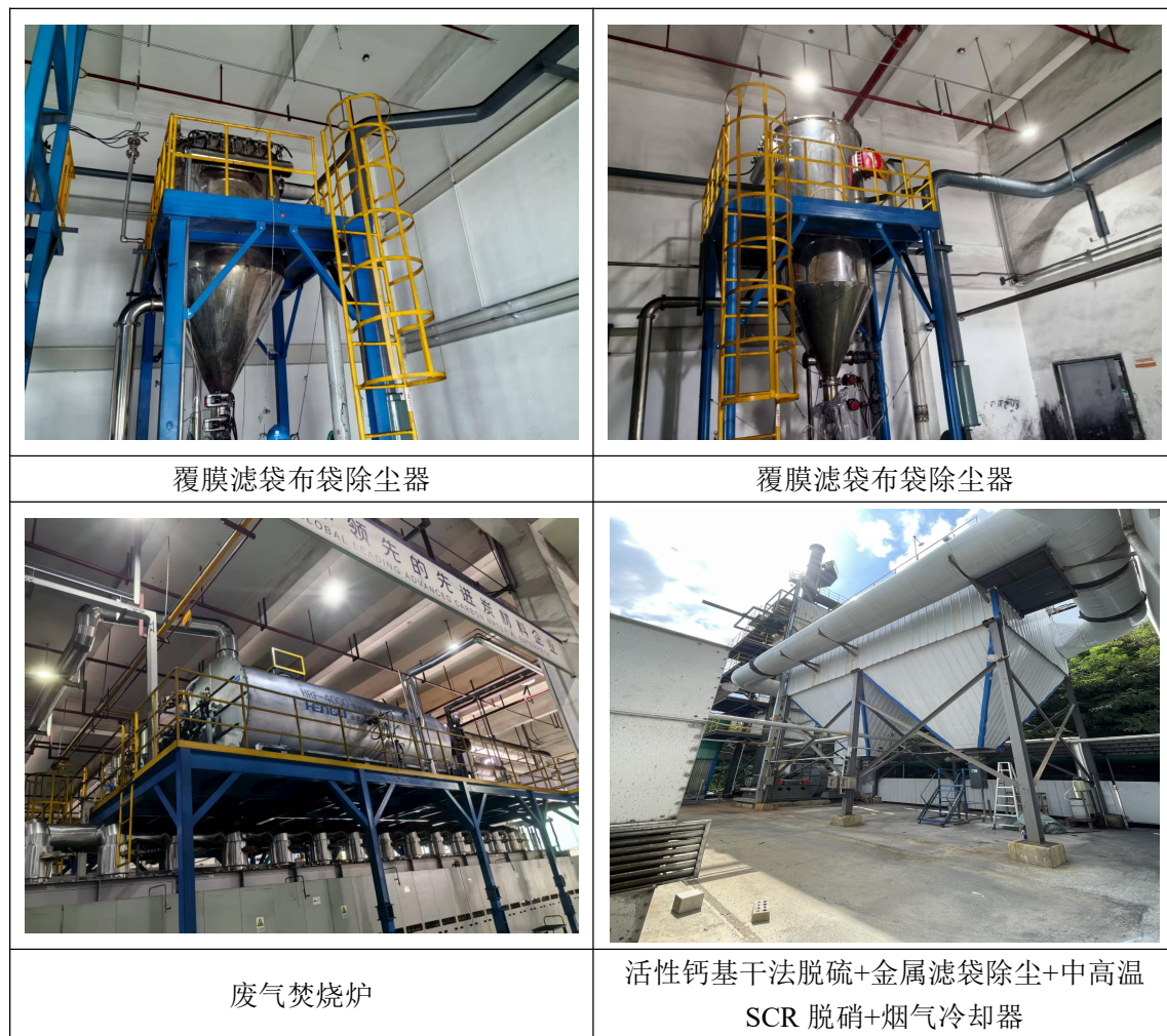
图 4-3 本项目废气处理设施照片
