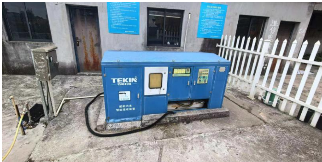
船舶生活污水接收设施
