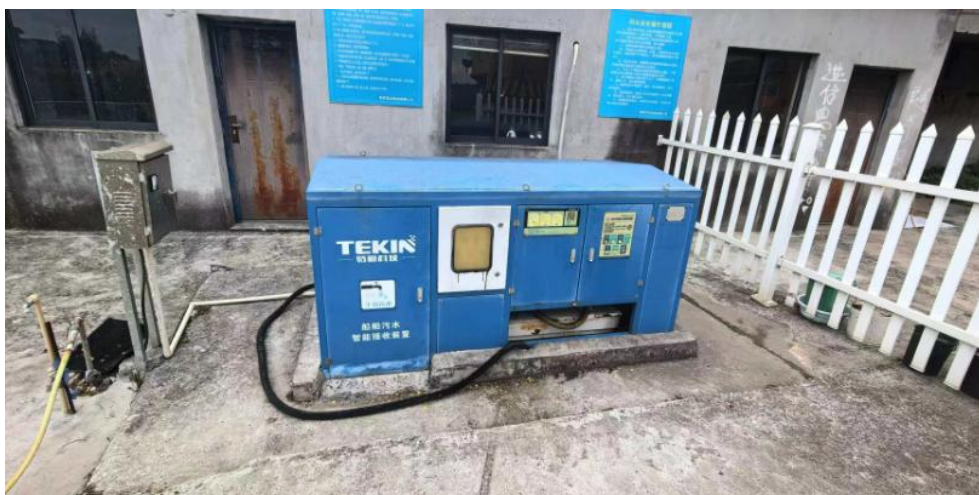
船舶生活污水接收设施
